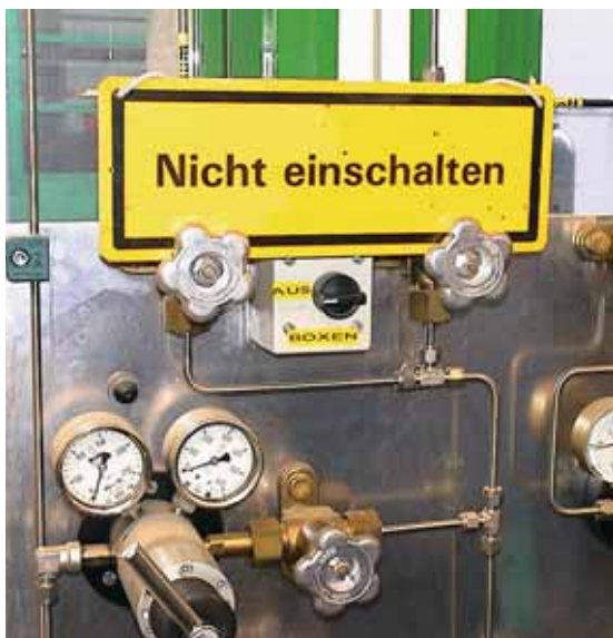
Bild 25: Kennzeichnung einer nicht betriebsbereiten Anlage
