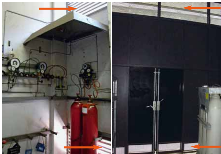
Bild 18: Öffnungen für die natürliche Lüftung
