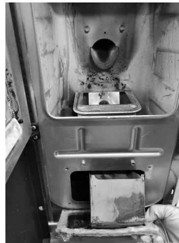
Fig. 60 - Den Inspektionsstopfen entfernen
