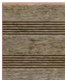
Verwittert nach ca. 1 Jahr im Außenbereich
