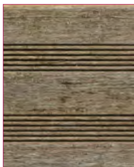
Verwittert nach ca. 1 Jahr im Außenbereich
